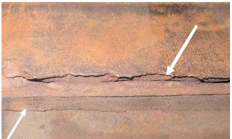
5 Von der Schiene verdeckt gewesene Längsrisse im Gurtblech über der Gurt-Steg-Halsnaht (großer Pfeil). Der in der oberen Bildhälfte erkennbare Teil des Obergurtes ist der zum freien Gurtrand hin gerichtete Teil des Obergurtes. Im Bildvordergrund nach unten gerichtet sieht man die Innenseite des Hauptsteges mit einem unterhalb der Steg-Halsnaht entstandenen, wenig klaffenden, gezackten Steg-Längsriss (kleiner Pfeil). Die zwischen den beiden Pfeilen verlaufende waagerechte Linie ist die obere Innenkante des Hauptsteges.
