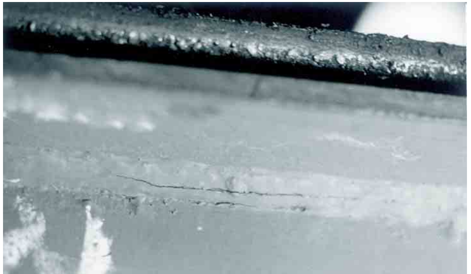
4 Längsrisse in der Gurt-Steg-Halsnaht; am oberen Bildrand ist der Schienenbart der verschlissenen Schiene zu sehen.
