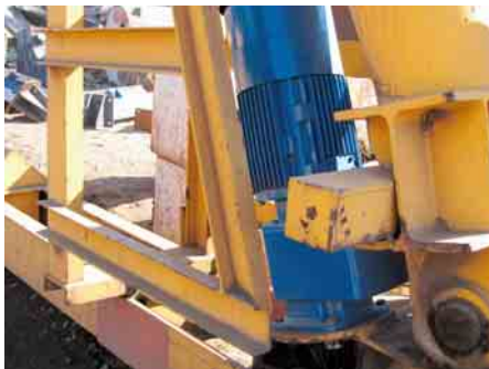
3 Erneuerter Fahrtrieb eines Portalcranes 5 t x 35 m
