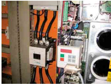
2 Teil der erneuerten Schaltanlage eines Zangenkranes 10 t x 16 m
