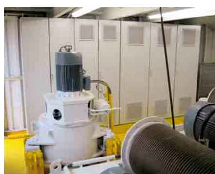
5 Ansicht des für vergrößerte Drehgeschwindigkeit erneuerten Drehwerk-antriebes eines Portaldrehkranes für Greiferbetrieb (Bilder: KSR, NL Ost)
