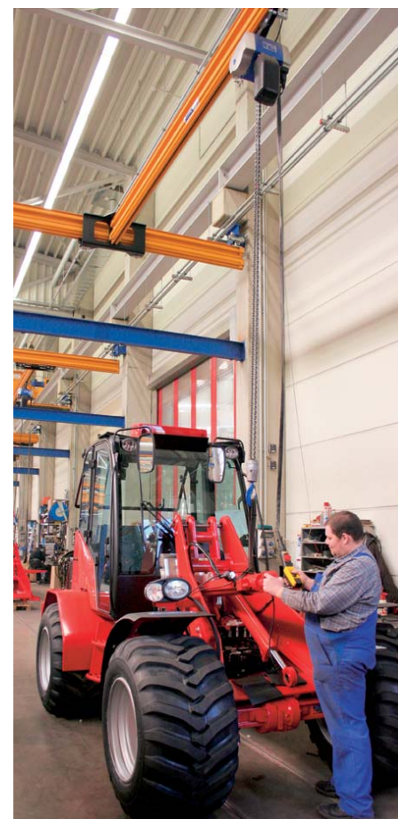
Bei der Montage der großen Teleskopklader kommen Krane EHB-X mit einer Tragfähigkeit von 1000 kg zum Einsatz. Der Stahlbau konnte schlank gestaltet werden, weil die HB-Kranbahn an der Konsole der Betonstütze aufgehängt ist
