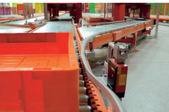
1 Wegentscheidungen im weit verzweigten Fördersystem werden durch Barcodelesung getroffen
