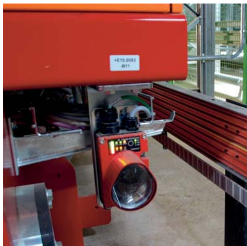
③ Sensorik an den RBG: positioniert wird mit Barcodetechnologie, die Positionsdaten werden mit Datenübertragungs-Lichtschranken übermittelt
