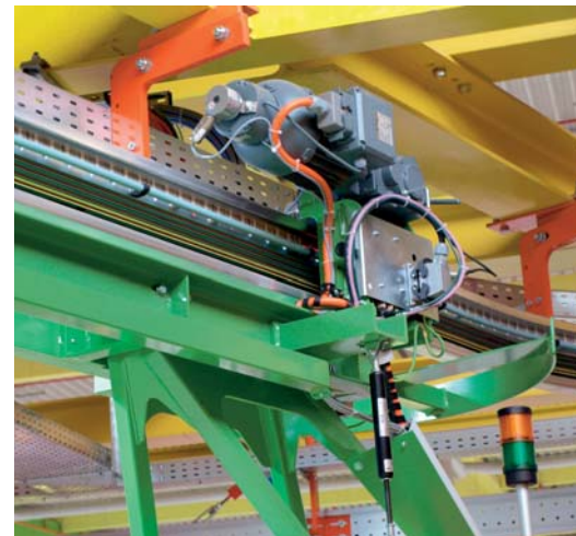
2 Die CaddyPick®-Elektrohängebahn-Fahrzeuge werden per Barcode-Positioniersystem gesteuert. Das Lesegerät im Hängewagen scannt das Codeband in der Führungsschiene
