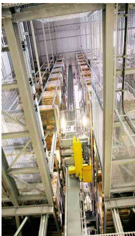
Vier der acht Gassen sind mit Regalbediengeräten des Typs MSingle ausgestattet
