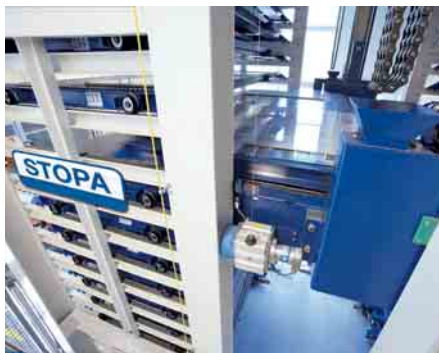
Das Ein- und Auslagern der Systempaletten zwischen den beiden Regalblöcken des Stopatower Flex übernimmt eine Lasttraverse, die mit einer Zieh-/Schiebetechnik arbeitet
