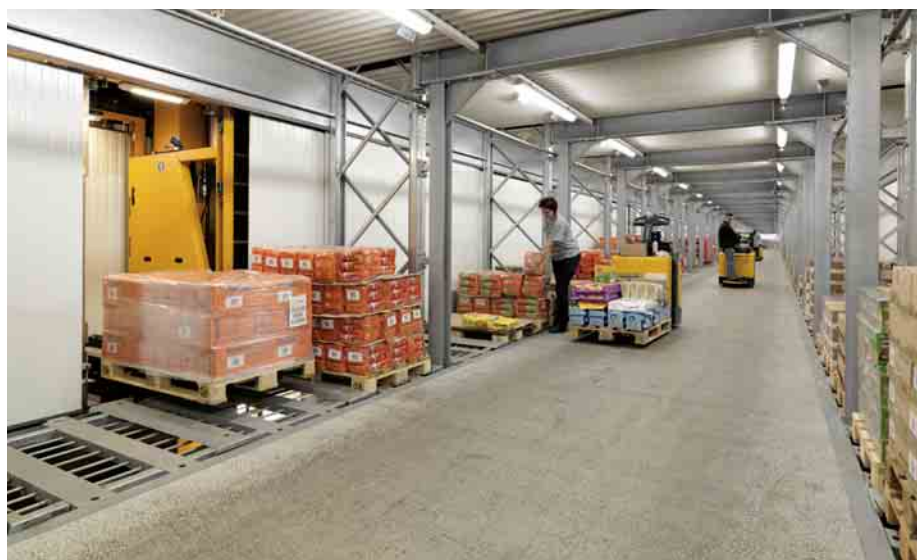
1000 automatische Schiebetore trennen den Kommissionierbereich von den RBG-Gassen
