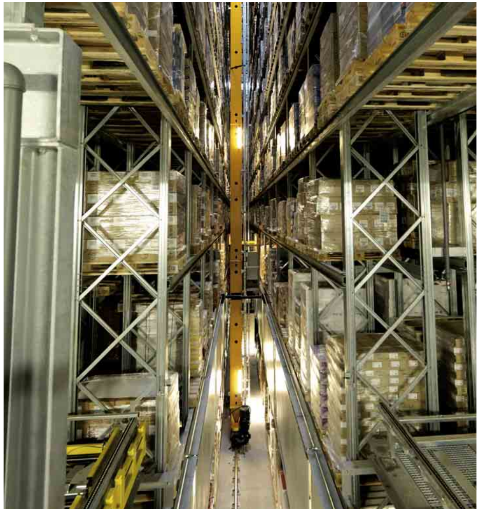
Die schienengebundenen RBG mit Teleskopgabeln arbeiten in fünf Regalgassen, die jeweils über 100 m lang sind
