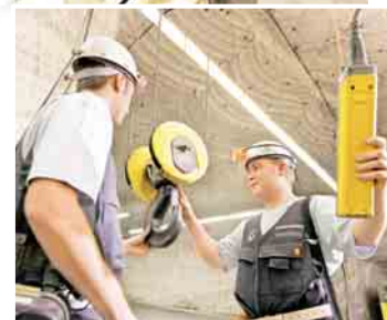
... denn die Krananlagen sind im Bergwerk einem besonders korrosiven Umfeld ausgesetzt
