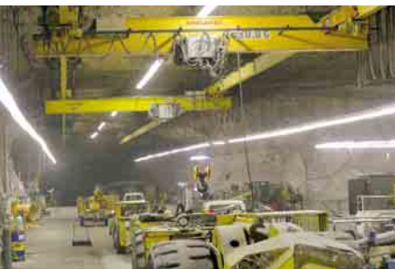
Zur Werkstattausrüstung unter Tage gehören auch Brückenkrane CXT mit Tragfähigkeiten bis 10 t
