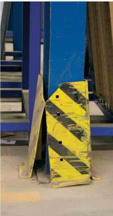
Schäden am Rammerschutz können die Stabilität einer Regalanlage negativ beeinflussen
