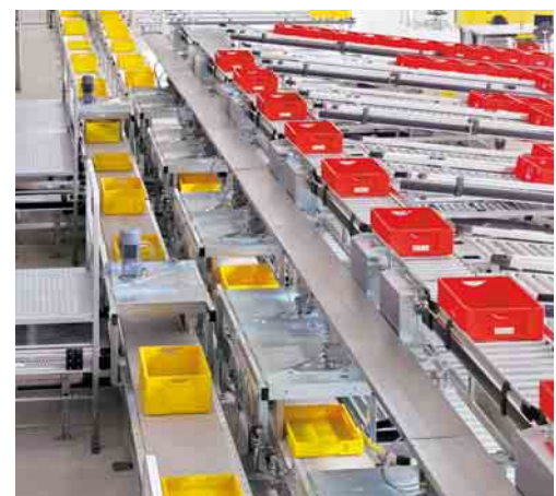
Gelbe Lager- und rote Auftragsbehälter am Loop zwischen Wareneingang, AKL und Kommissionierung
