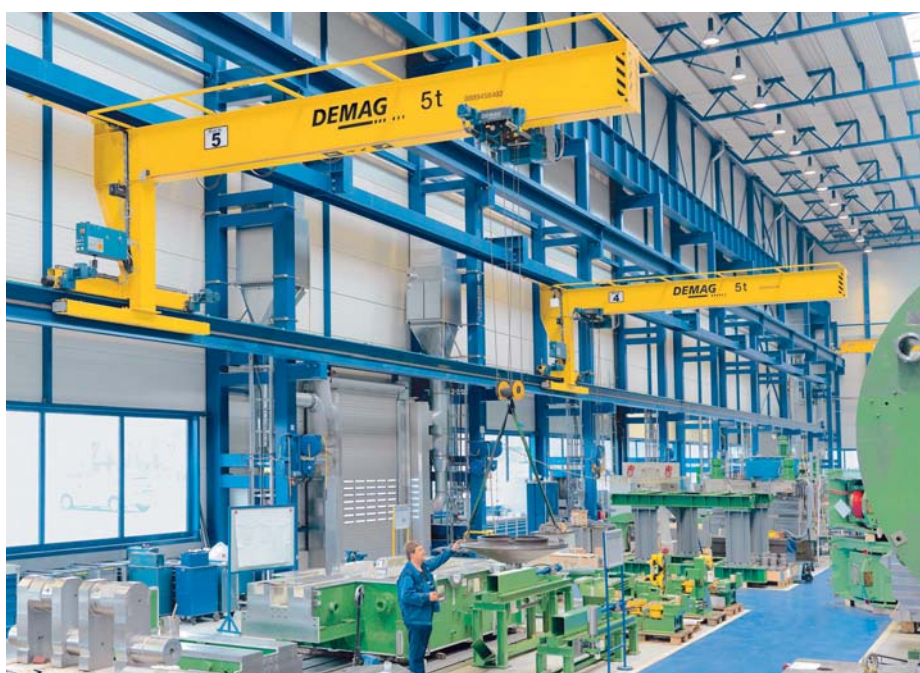
Konsolkrane in der dritten Ebene übernehmen Transportaufgaben und unterstützen die Montagearbeiten (Bilder: Demag Cranes & Components)
