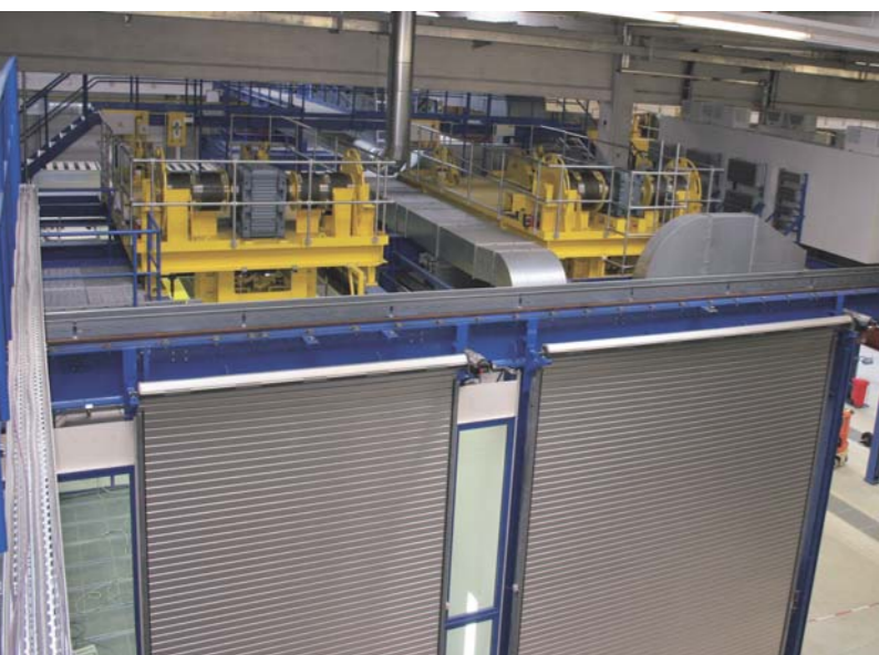
1 Perfekter Ex-Schutz: Die Reibradantriebe für den Transport und die Hubeinrichtungen (gelb) befinden sich außerhalb der Lackier- und Pulverkabinen
