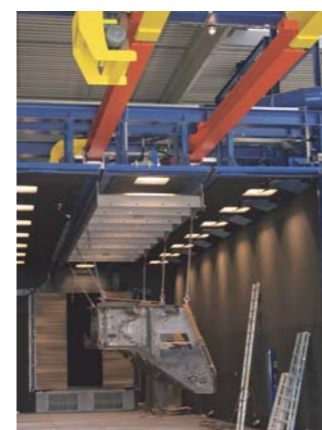
3 In die Strahlkabine kommen lediglich die Transporttraverse und das Werkstück – die Hängelaufbahn und der Reibradantrieb (rot und gelb) befinden sich oberhalb der Kabine
