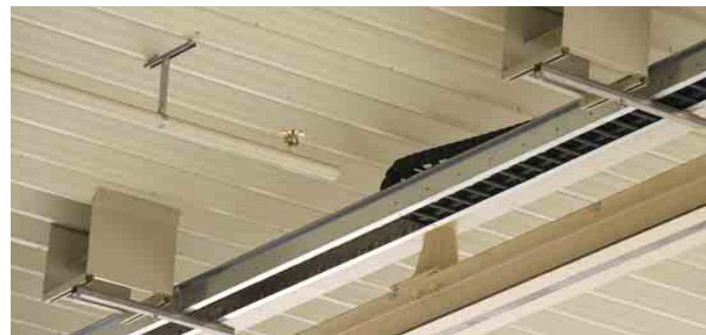
Platzsparend: Kranträger und parallel montierte Führungsrinne mit gleitender Energiekette E4/0
